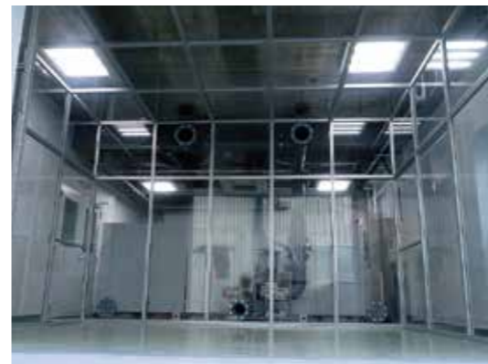
▲ 防じん試験室 (試験室: W4.3m×D3.0m×H2.9m)
