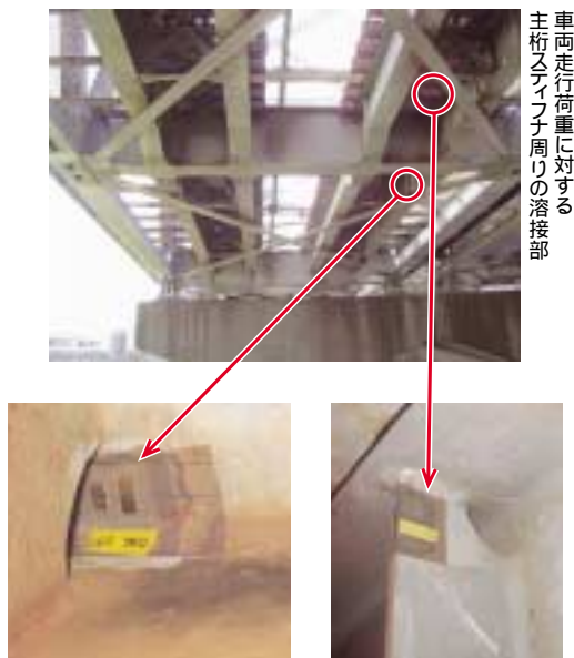
図4 実橋への疲労センサ貼付状況 Fig. 4 FDS application to bridge
